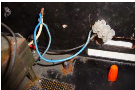
Loses Stromkabel: ein Sicherheitsrisiko
